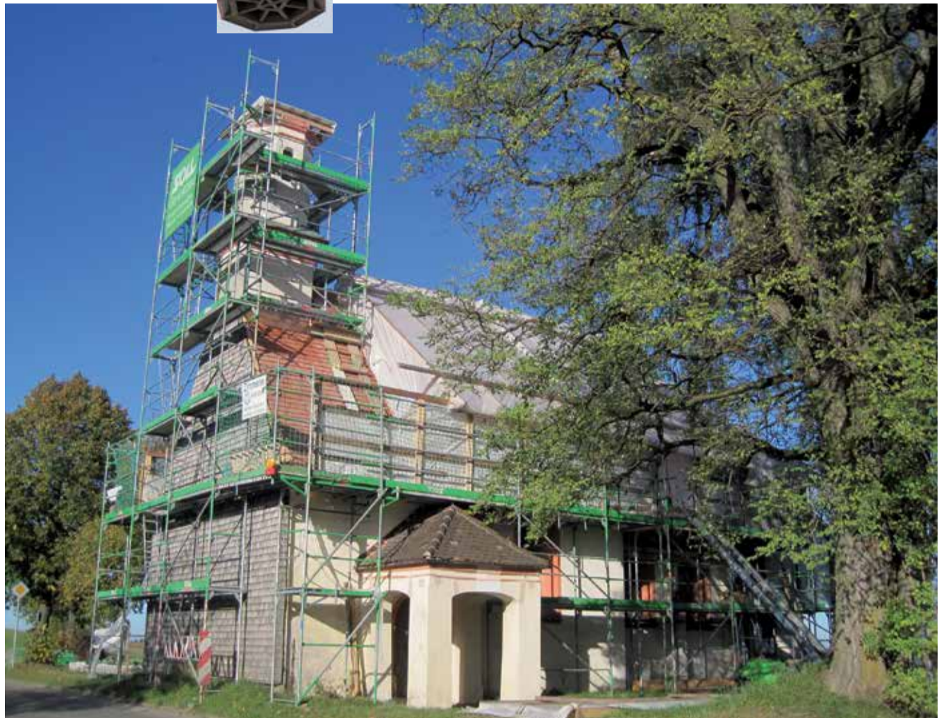
Die Sanierungsarbeiten an der Rotter Ottilienkapelle umfassten auch die Außenfassade und die Turmzwiebel.
